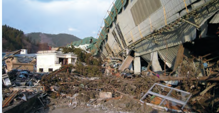
津波により建屋が倒壊した旧工場
